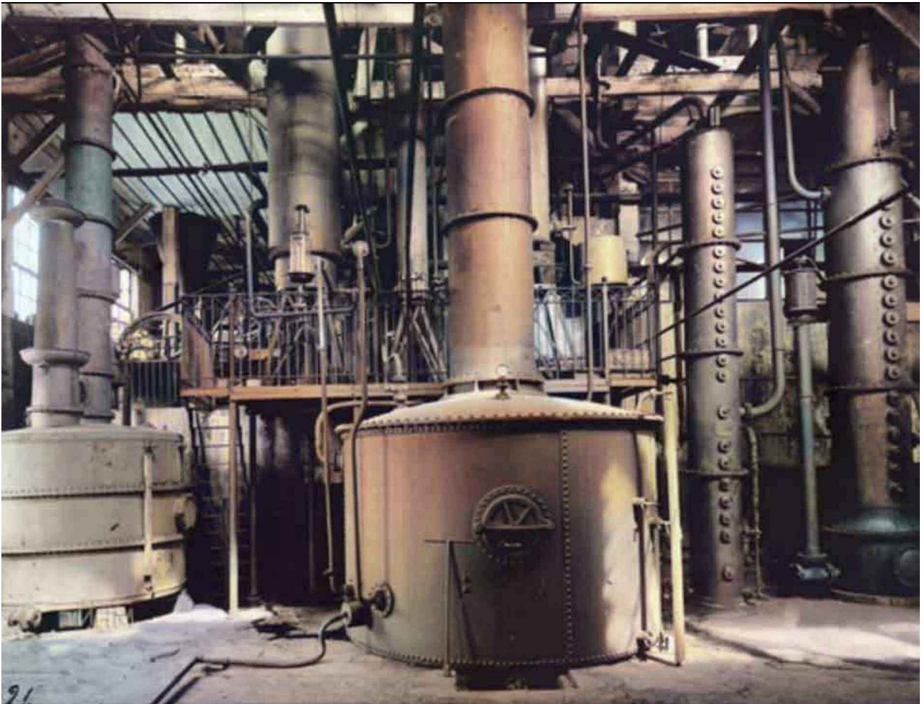
Interior de la antigua destilería asociada al complejo industrial: estanques, columnas, tuberías y otros elementos utilizados en la destilación de granos y papas.
